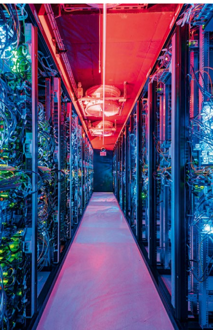
Infomaniak va construire un nouveau centre de données (ici son data center actuel) dans le futur écoquartier de Plan-les-Ouates.
